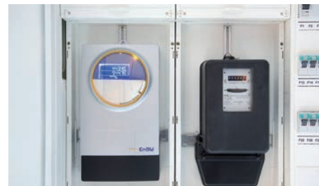
Digitale Stromzähler (l.) statt mechanische
